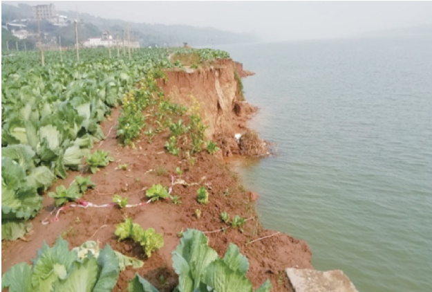
(a) 水库塌岸影响耕地
