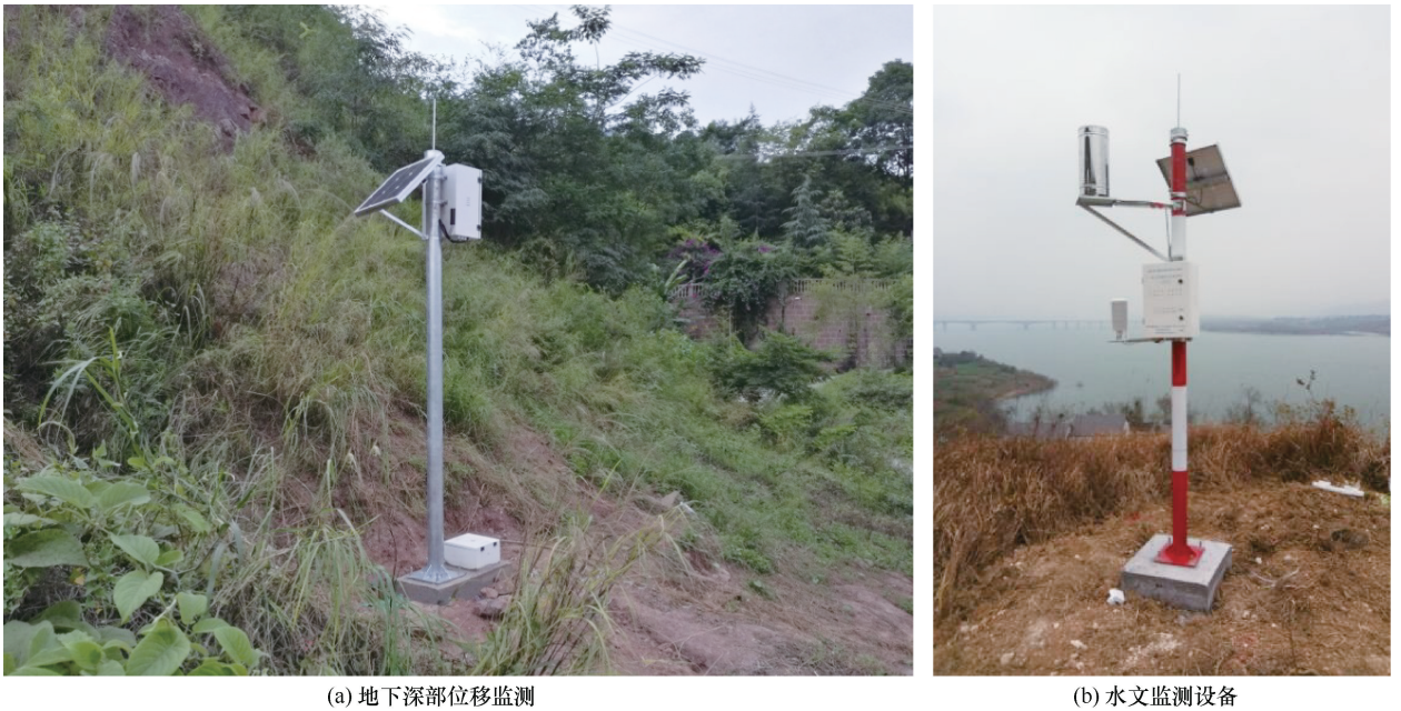
图6 地下深部位移监测及水文监测设备
