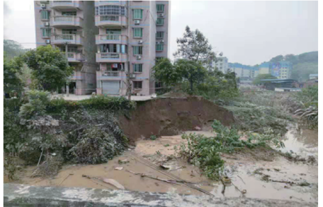
(b) 水库塌岸影响房屋
