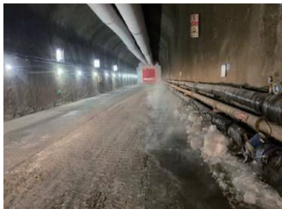
图1 极端温度下巷道结冰情况
