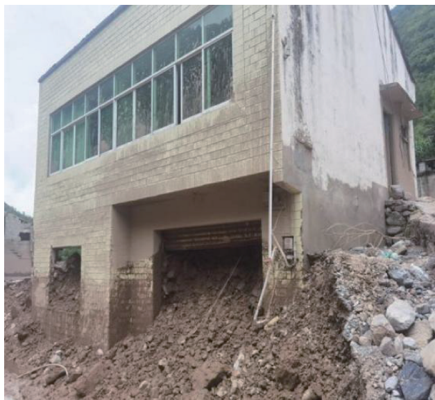
(a) 泥石流淤积冲毁房屋
