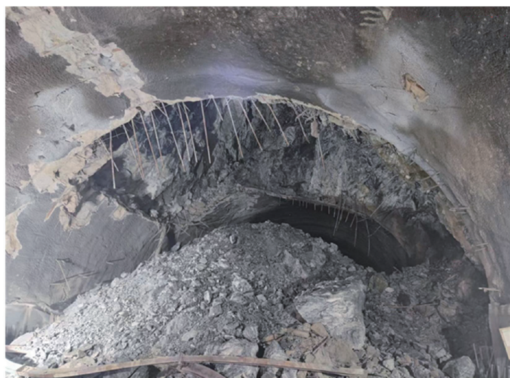
(b) K400+460—K400+500挤压段坍塌
