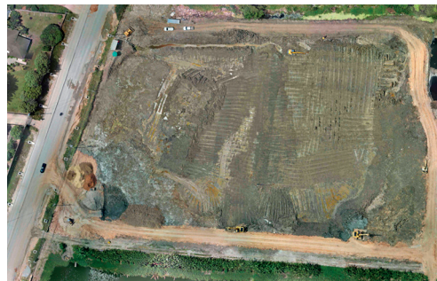
2nd Month: Initial earthwork of the site 第二个月：场地初始阶段的土方工程
