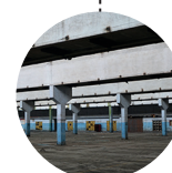
主厂房 Main plant
