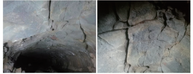
图9 不同角度的熔岩管内表面裂隙
